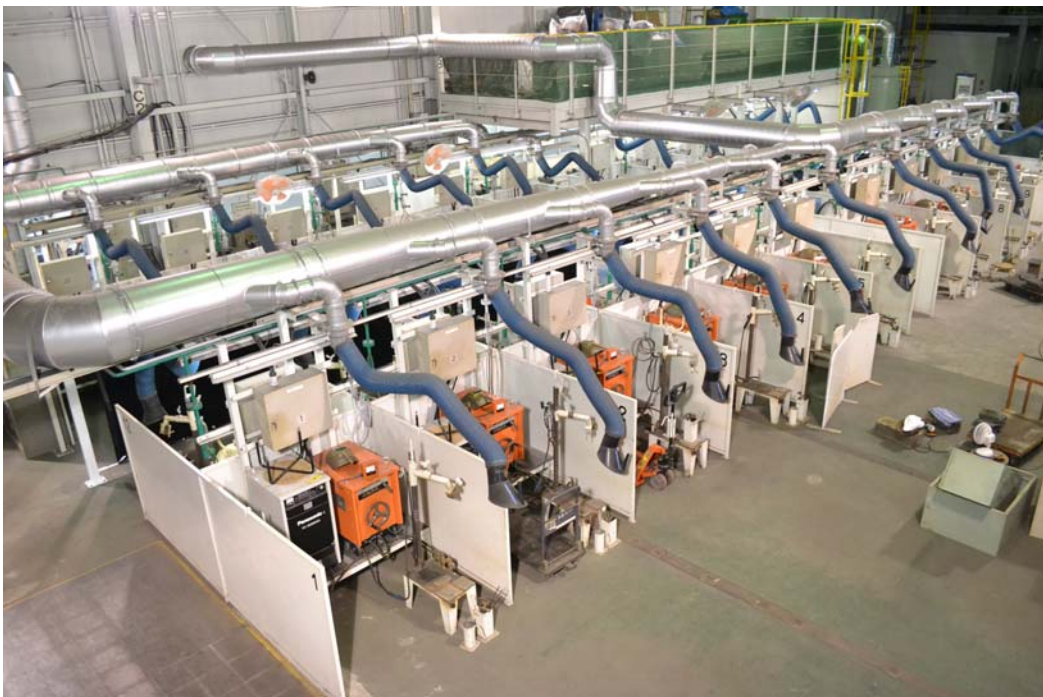
全 33 の溶接ブースを設ける (北九州市八幡西区、西日本能力開発センター)
