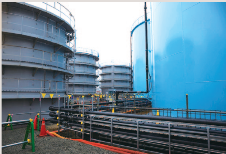
▶ 東京電力ホールディングスで福島第一原子力発電所のフランジ型タンクに貯留しているALPS (多核種除去設備) 処理水の溶接型タンク (右) への移送が完了
