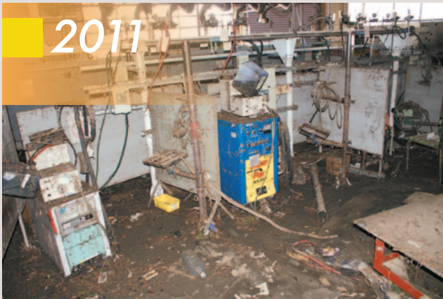
◀ 3月11日に発生した東日本大震災の爪痕。被災したポリテクセンター宮城（多賀城市）の冠水した溶接実習場。日本溶接協会溶接技能者評価試験に会場を提供していた同センターは県内の溶接関係者にとって溶接技能者を養成する重要な役目を担っていた
