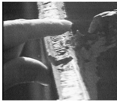
(b) Face Plate 突合せ溶接部の未溶着部
