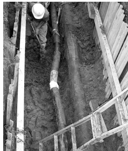
図1 小口径高圧ガス導管の長柱座屈
