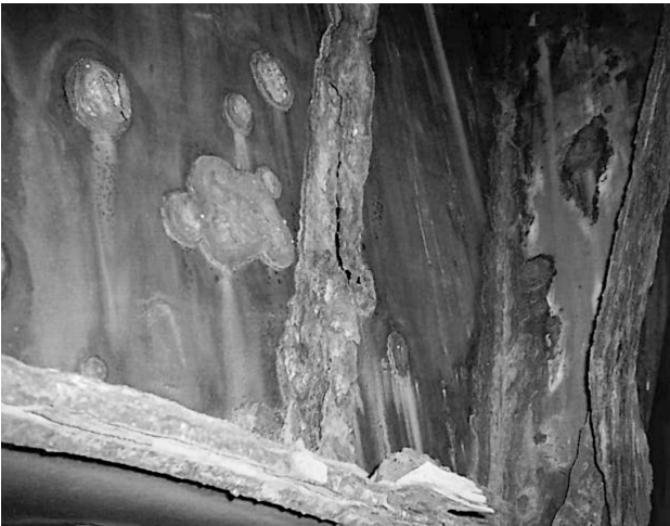
図7 腐食したバラスタククの一例
