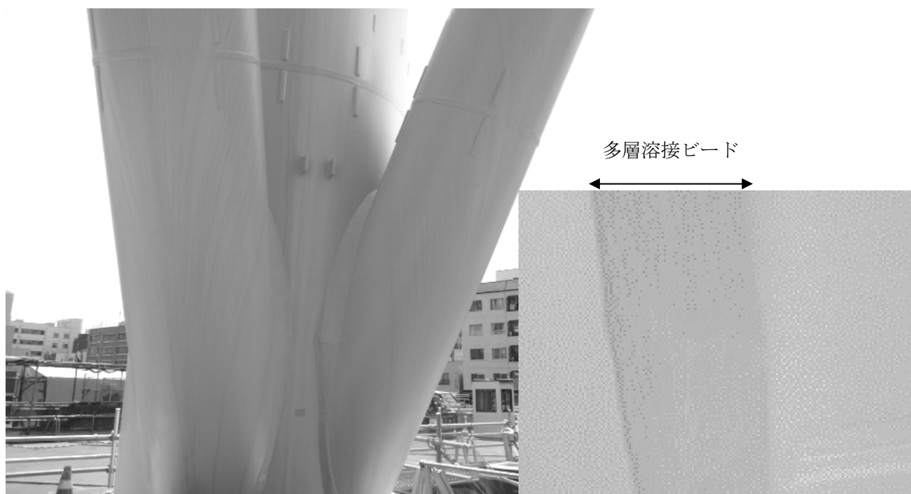
図 4 鼎トラス（柱：直径 2.3m×厚さ 100mm の YS500MPa 級高張力鋼）の多層隅肉溶接（FCW 溶接） 3)
