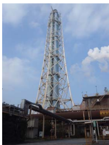
図 5.1 火力発電所内の煙突
