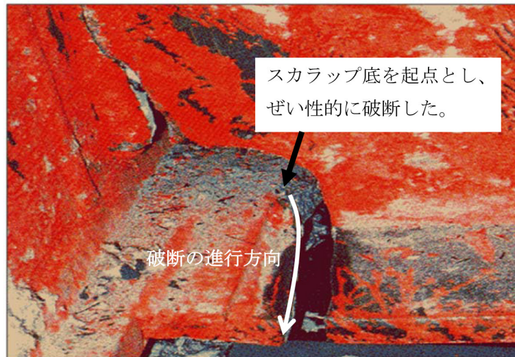
図4 梁端溶接接合部のぜい性的破断の例 5) （スカラップ底からの破断、矢印：筆者追記）
