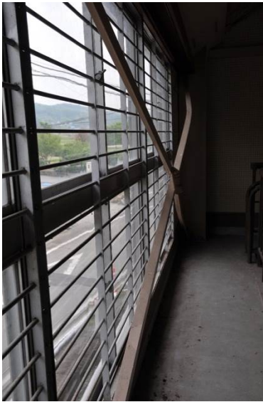
図3 鉛直ブレースの座屈
