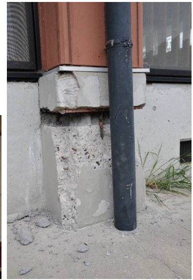
図5 柱脚の側方破壊
