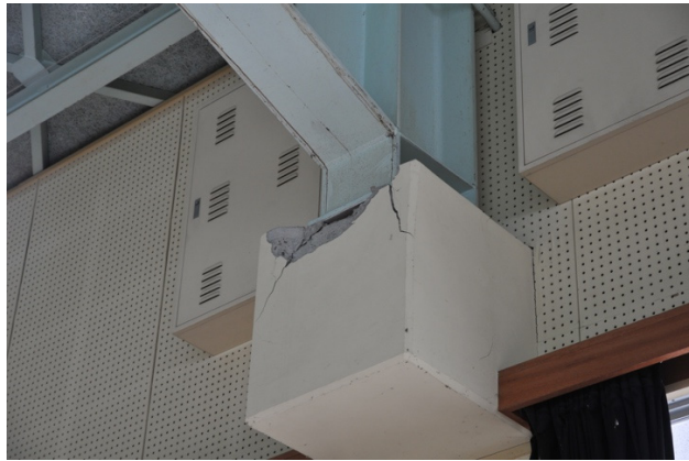
図6 置屋根形式支承部の側方破壊
