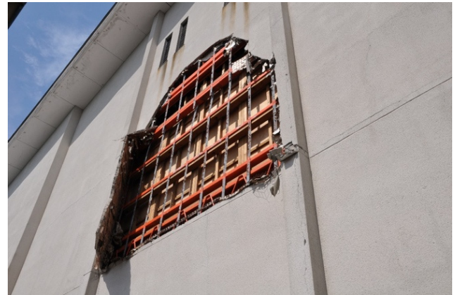
図7 外装材のひび割れと剥離・剥落
