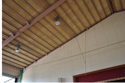
図4 天井ブレースの破断
