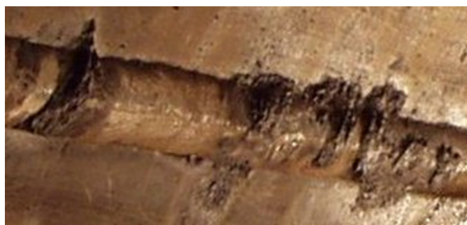
写真5 腐食部(錆こぶ部)
