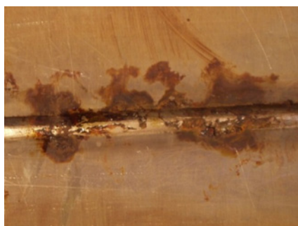
写真4 腐食部(ヘドロ除去後)
