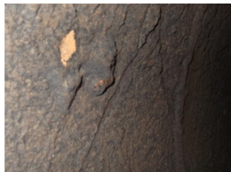
写真3 付着したヘドロ(凸部は錆こぶ部)
