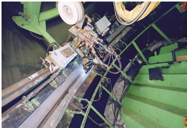
図 13 片面 MAG 自動溶接装置
