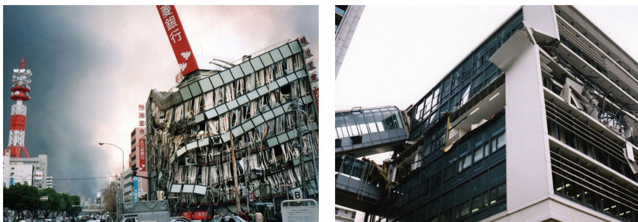
図1 阪神大震災での建物の被害事例
