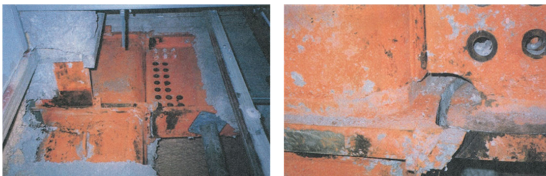
図1 兵庫県南部地震における柱梁接合部の被害
