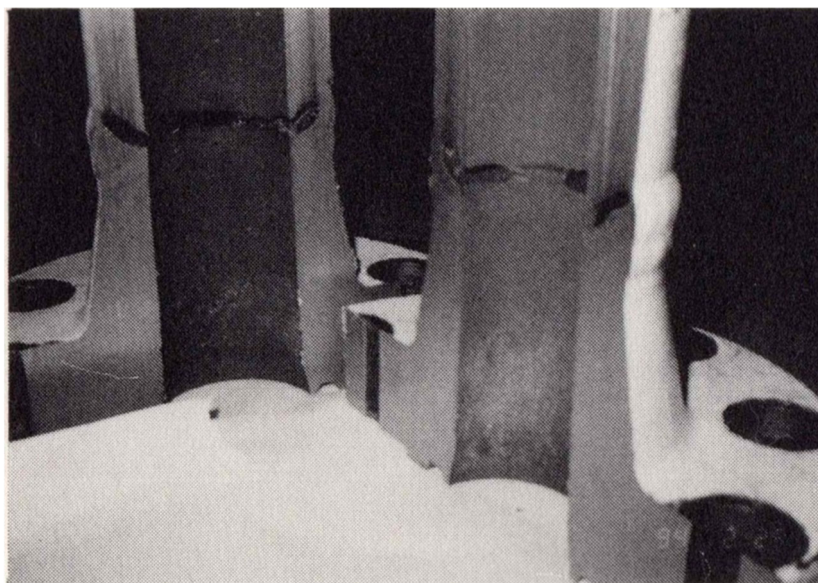
図 5 チョーク弁下流での溶接金属の優先的腐食事例 7)
